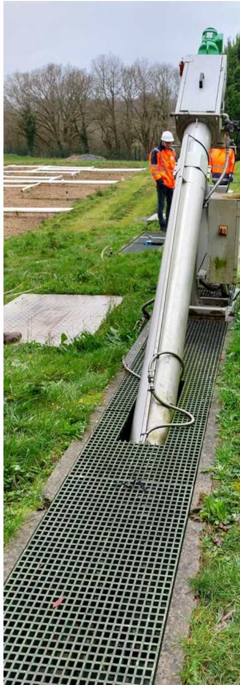
Figure 5 : arrivée des eaux à la STEP et dégrilleur
