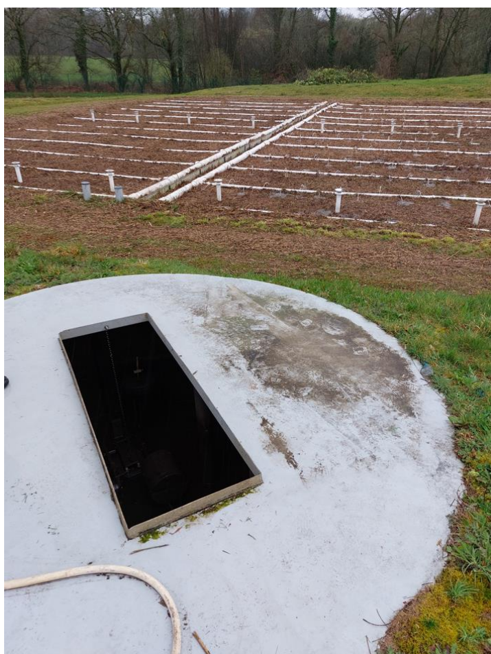
Figure 11 : Deuxième étage de lits plantés de roseaux
